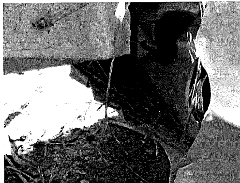
Daño a la estructura interna
